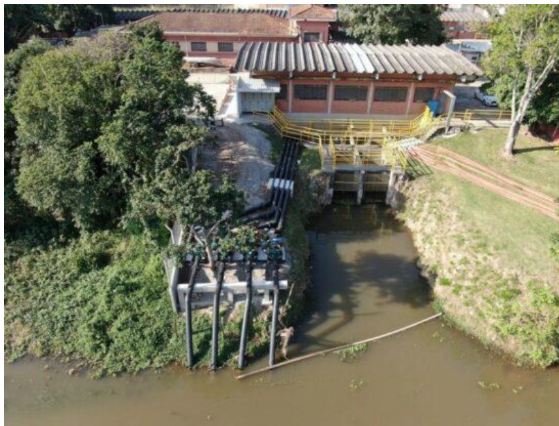
Figura 7 – Sistema de captação de água superficial do município de Jacareí do estado de São Paulo
