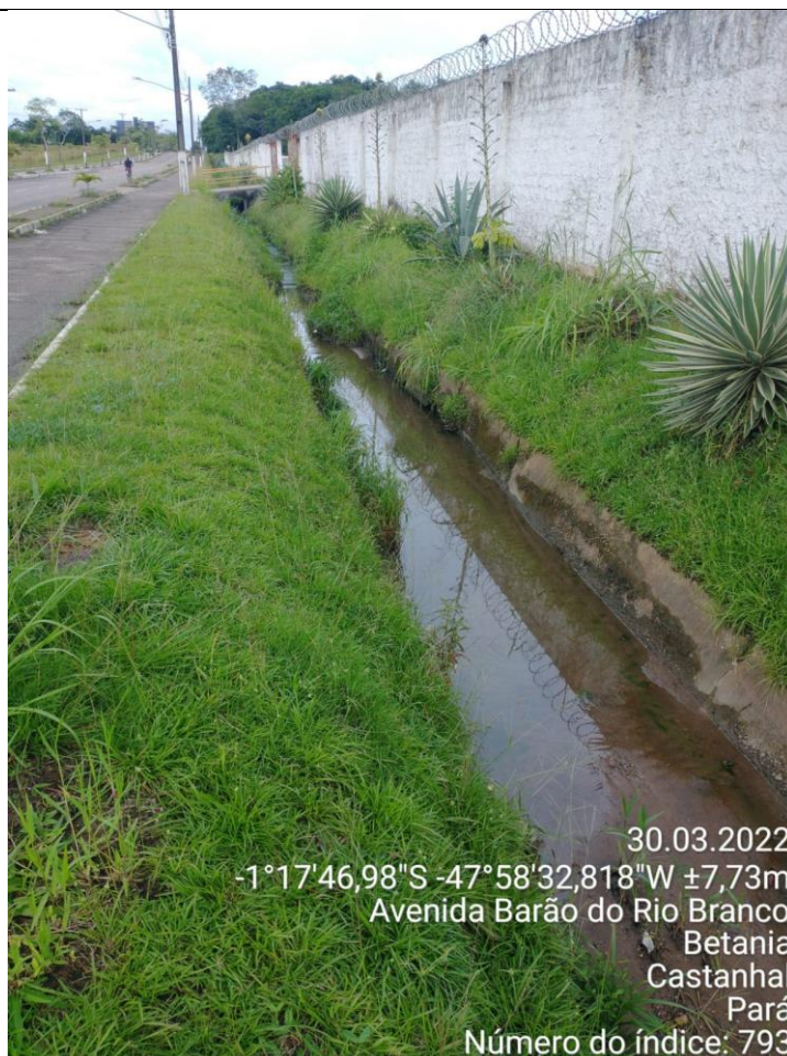
Trecho: Efluentes da Fabrica Mariza, Apeú.
