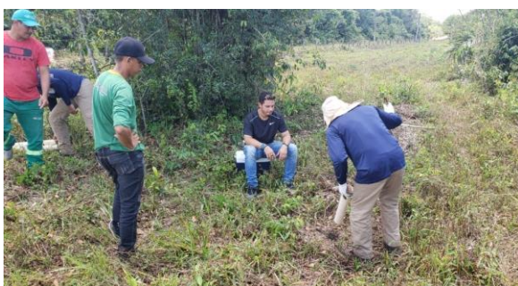
Foto 5: Execução do furo de trado para realizar teste de infiltração no ponto 16, Área 4.
